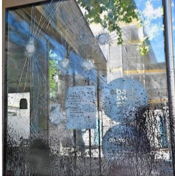
Die beschädigte Glasfront in der Lorraine. Foto: Stephanie Matti
